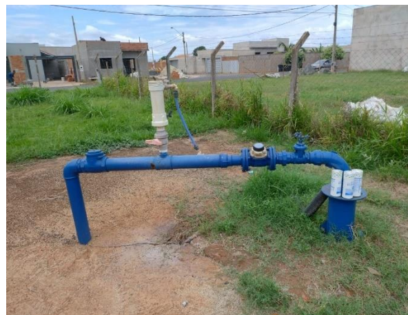
Figura 38. Detalhe das instalações do Poço P4.
