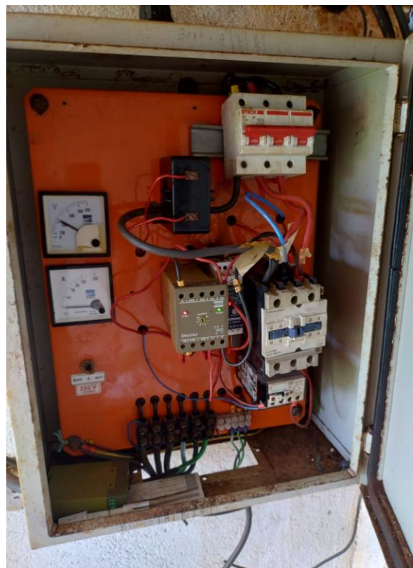
Figura 43. Vista do Painel Elétrico do Poço P5.
