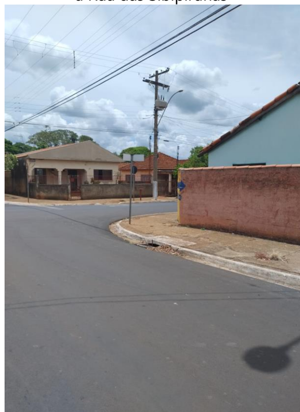
Figura 132. Boca de lobo localizada no cruzamento da Rua das Sibipirunas com a Rua dos Oleandros
