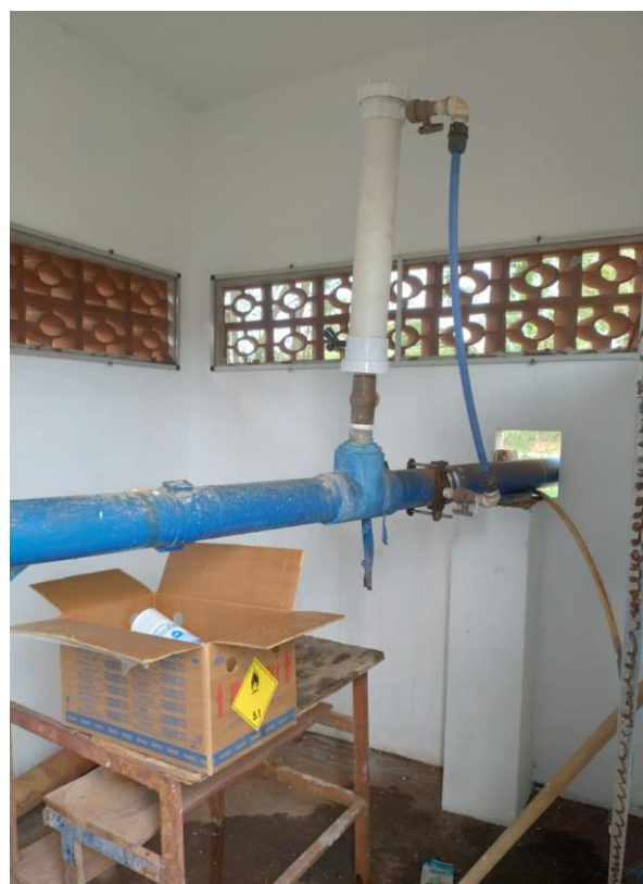
Figura 36. Detalhe do sistema de cloração por pastilhas no Poço P3.
