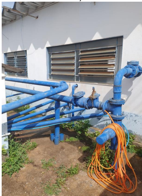
Figura 49. Detalhe das tubulações de saída do reservatório R1 para as bombas de recalque
