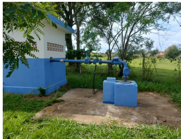
Figura 34. Detalhe das instalações do Poço P3.
