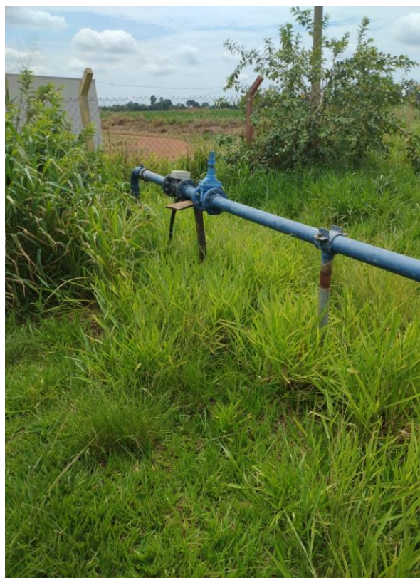
Figura 41. Detalhe das instalaes do Poço P5.
