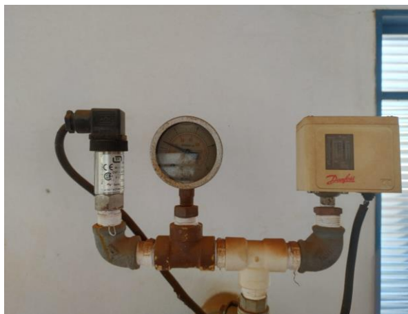
Figura 48. Sensor de pressão na tubulação de recalque.
