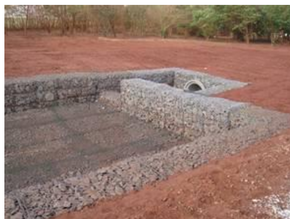
Figura 106. Sistema de drenagem de águas pluviais
