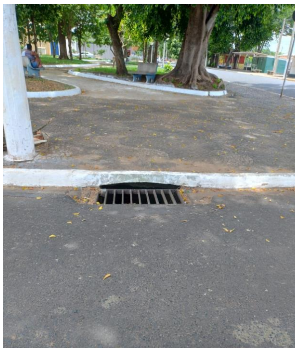
Figura 127. Boca de lobo localizada no cruzamento da Rua Hermínio Félix Bonfim Mínio com a Rua José Linares Neto em frente à praça
