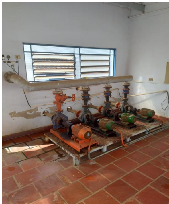
Figura 47. Bombas de recalque na saída do Reservatório R1 para a rede de distribuição.
