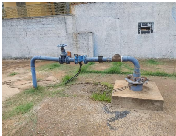
Figura 30. Detalhe das instalaes do Poço P1.
