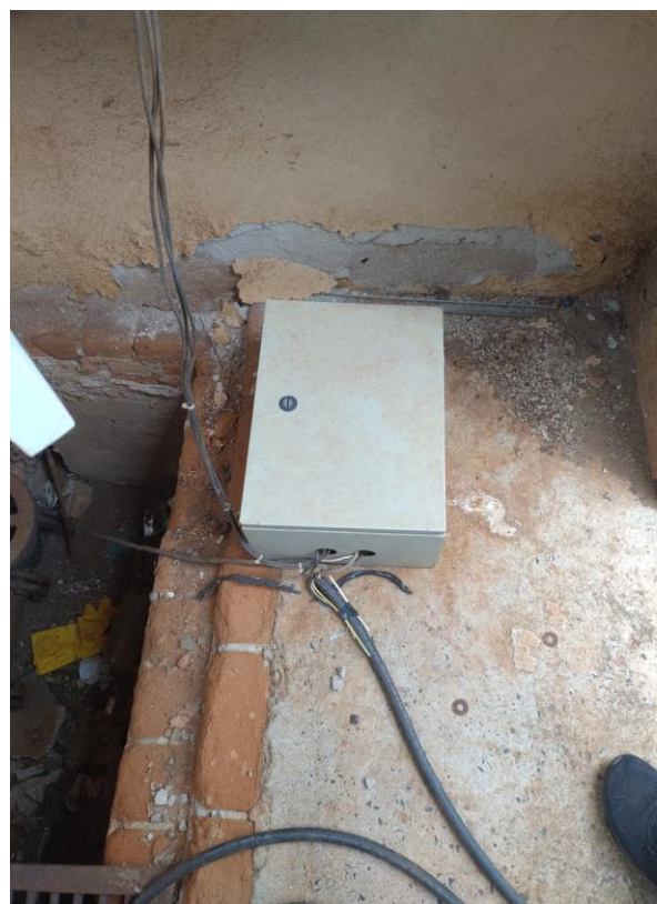
Figura 64. Detalhe do painel elétrico da EEBB COHAB, sem instalação
