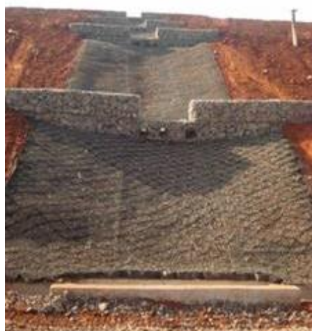
Figura 105. Sistema de drenagem de águas pluviais
