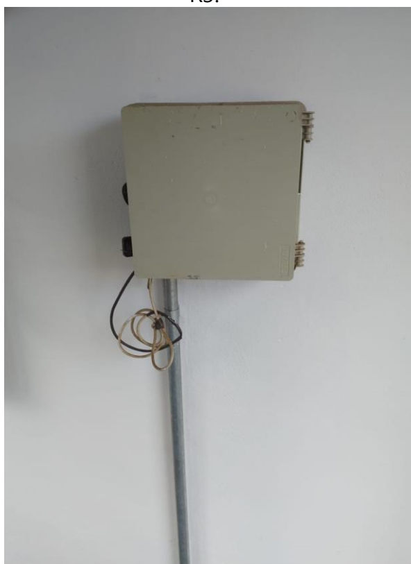
Figura 52. Detalhe do painel da telemetria instalada.
