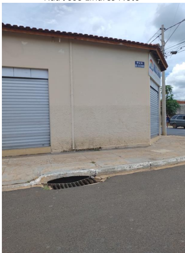
Figura 131. Boca de lobo localizada no cruzamento da Rua dos Alecrins com a Rua Breno Vieira de Aquino Leite
