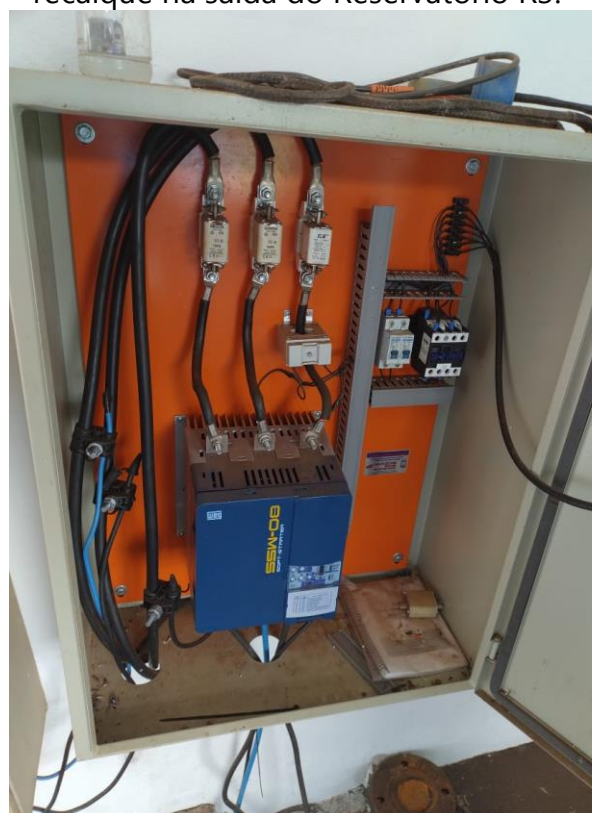
Figura 53. Detalhe do painel elétrico das bombas de recalque do R3.
