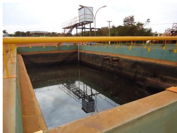
Figura 104. Tanque de acumulação de lixiviado
