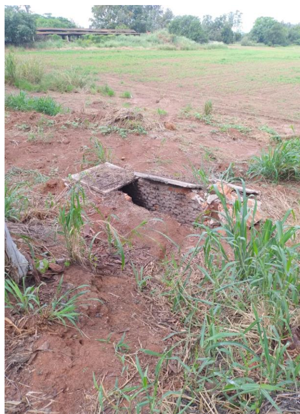
Figura 85. Caixa de passagem com a tampa quebrada para o lançamento em curso d'água
