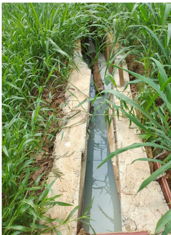
Figura 80. Vista do canal de entrada e Calha Parshall na chegada da ETE Mombuca
