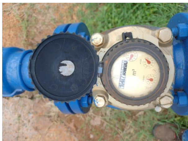
Figura 39. Detalhe de macromedidor instalado no Poço P4.
