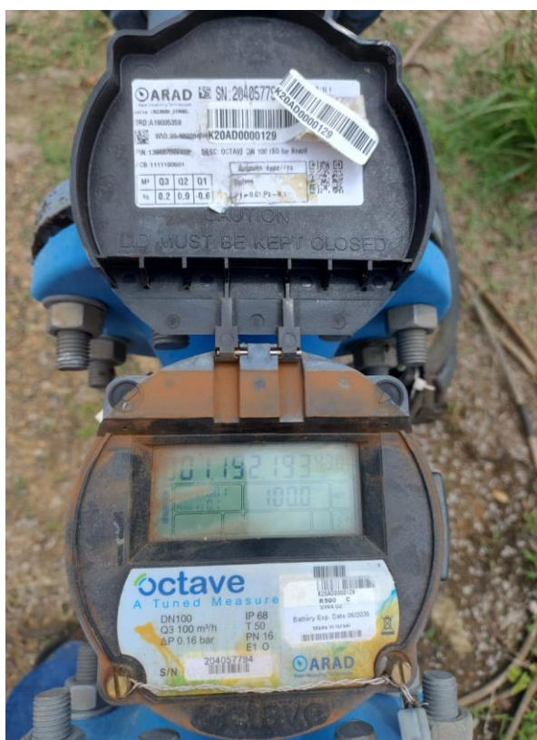
Figura 31. Detalhe de macromedidor eletromagntico instalado no Poço P1
