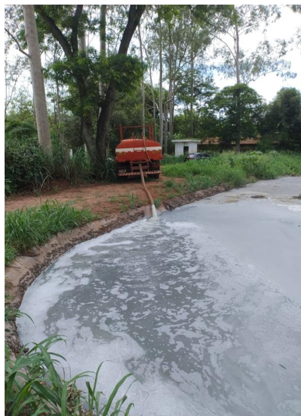
Figura 81. Detalhe do lançamento de efluente direto na lagoa de tratamento sem passar pelo tratamento preliminar
