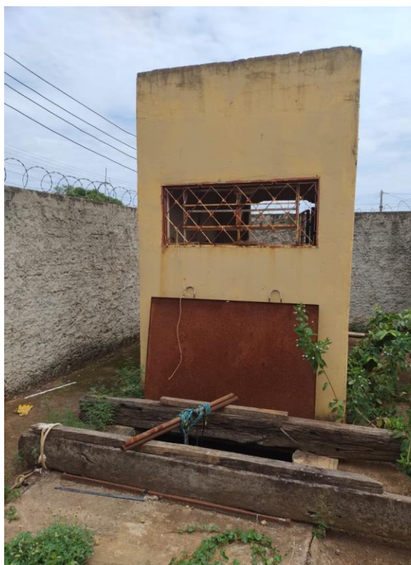
Figura 61. Vista geral da EEBB COHAB
