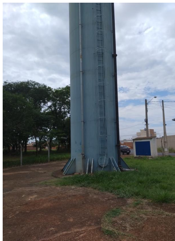
Figura 55. Detalhe da tubulação de limpeza no reservatório elevado R4.
