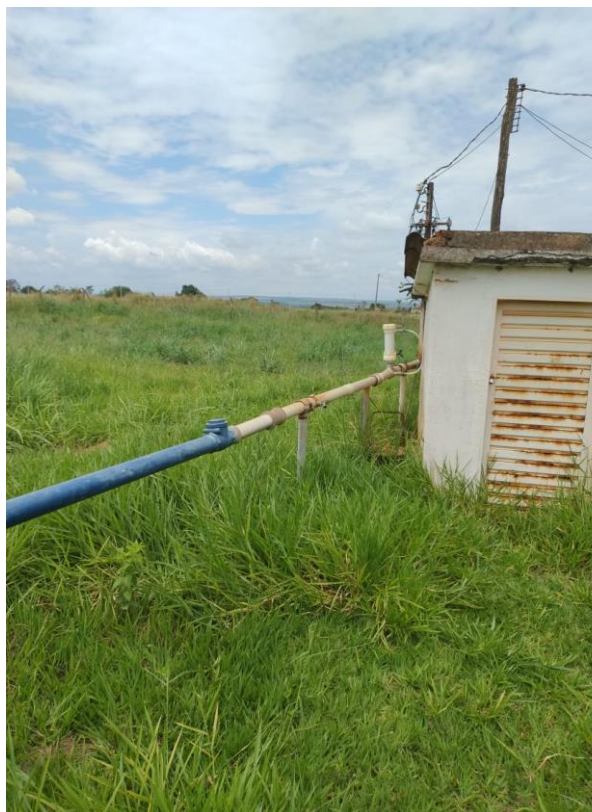
Figura 42. Detalhe da cloração por pastilhas no Poço P5.
