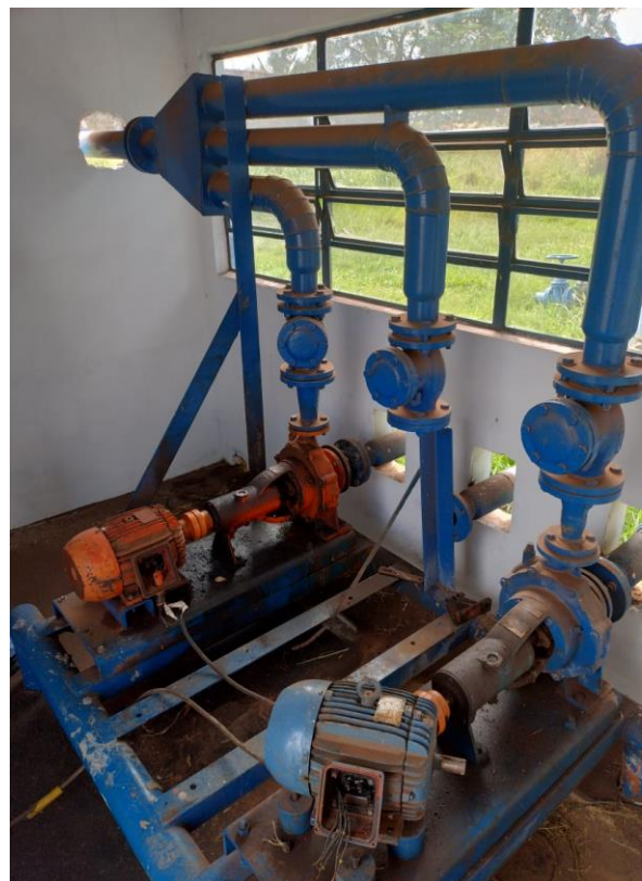
Figura 51. Detalhe das bombas de recalque na saída do Reservatório R3.
