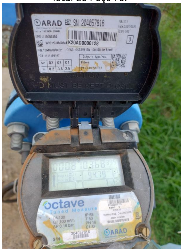
Figura 35. Detalhe de macromedidor eletromagnético instalado no Poço P3
