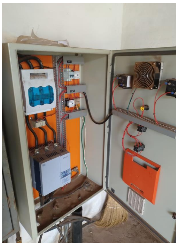
Figura 32. Detalhe do painel eltrico com Soft starter instalado no Poço P1
