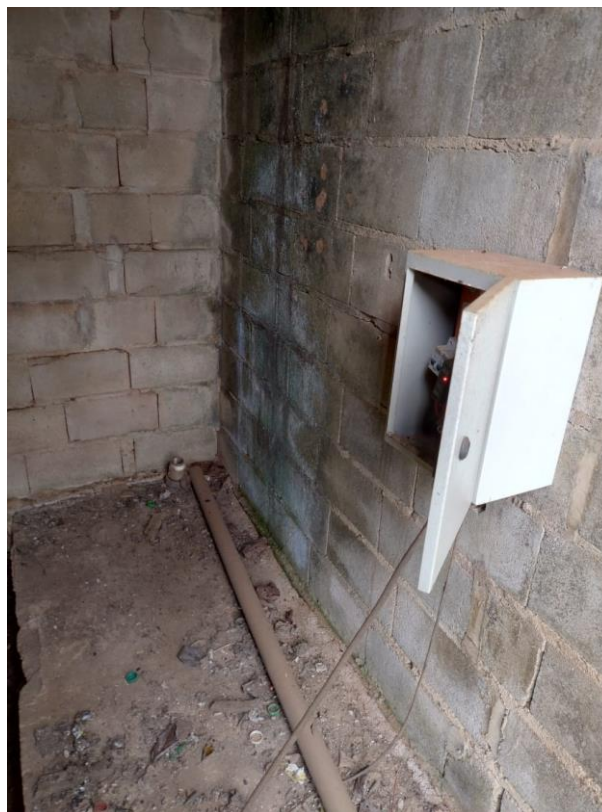
Figura 73. Detalhe do painel elétrico da EEB Maria Luiza.
